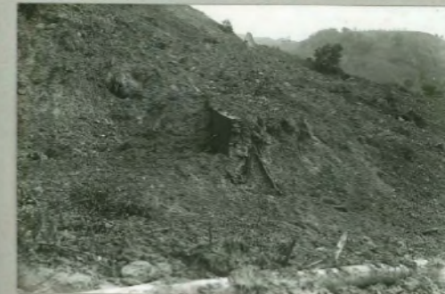
Modigliana - strada del Monte Trebbio asportata da frana
