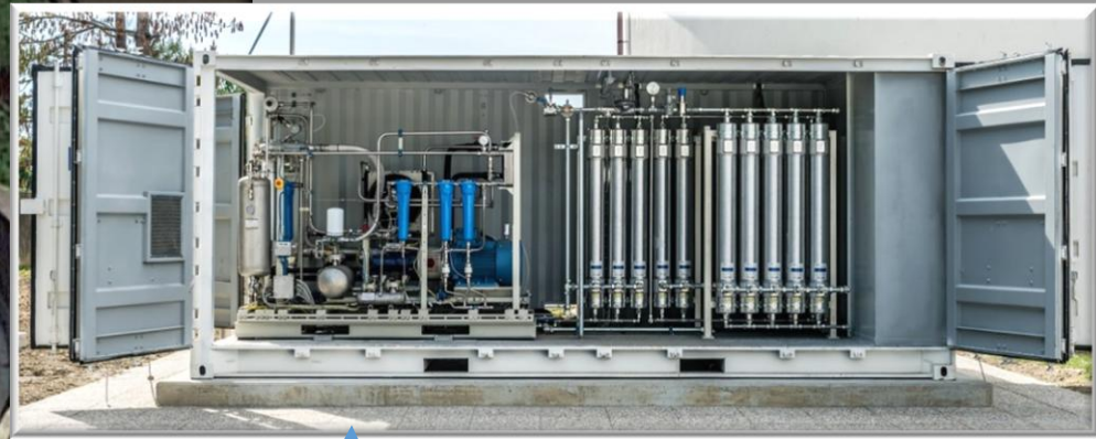
Impianto di upgrading (Membrane - SOL)
